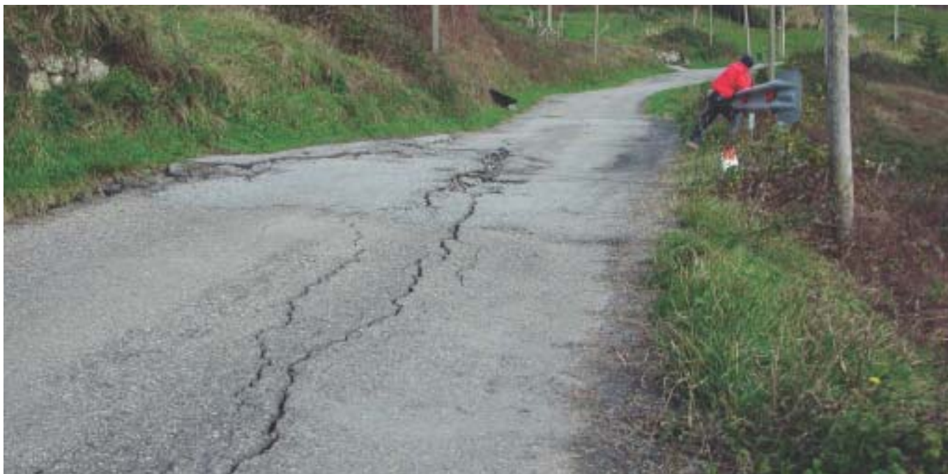
Foto 2 - Assalino (Comune di S. Olcese - GE) - Argilliti di Montoggio. Evidenti deformazioni della sede stradale che rendono manifesto un fenomeno la cui bassa velocità di evoluzione lo renderebbe difficilmente riconoscibile su un versante privo di marker rigidi.
