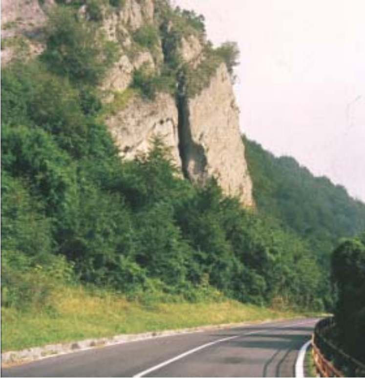
Foto 4.1.6 - Sorrivi (Comune di Savignone - GE) - Conglomerati di Savignone. Ribaltamento. Si può osservare una diaclasi beante subverticale che individua una colonna potenzialmente soggetta a ribaltamento.
