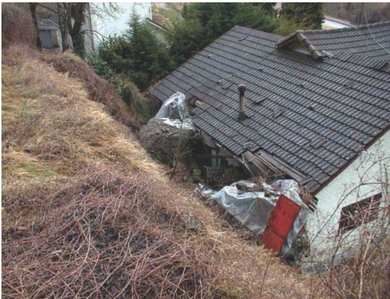
Foto 4.1.9 - Crocefieschi (Comune di Crocefieschi - GE) - Conglomerati di Savignone. Effetti del crollo di alcuni blocchi staccatisi da una soprastante parete caratterizzata da roccia affiorante fratturata.
