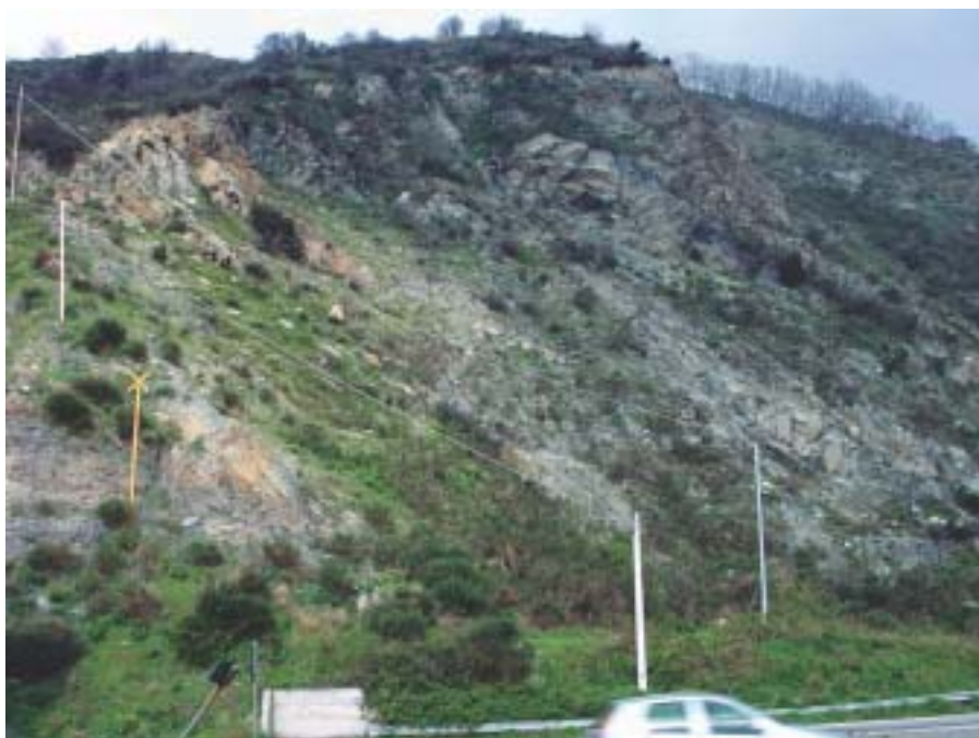
Foto 4.8.5 - SS 1 (Comune di Vado - SV) - Scisti della Formazione di Murialdo. Ampia zona instabile con diffusi fenomeni di crollo e ribaltamento.
