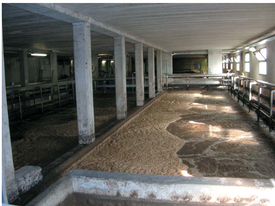
Particolare di un depuratore urbano con trattamento secondario - Vasca di ossidazione biologica coperta
